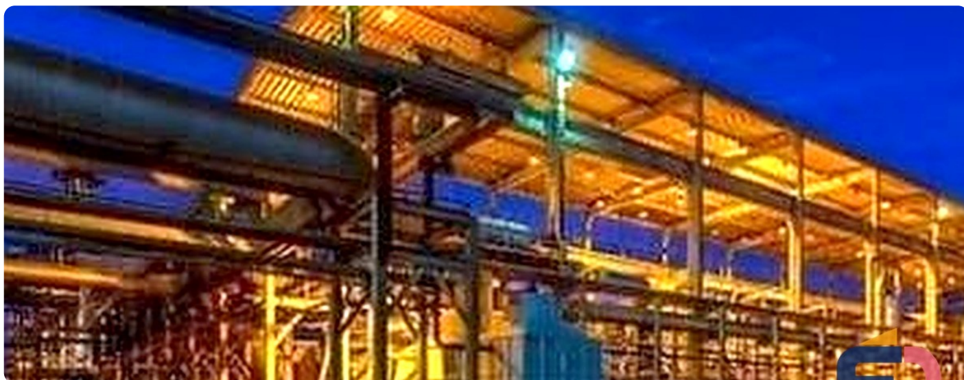
A usina às margens da Rodovia Castelo Branco, em Avaré, segue em operação.
