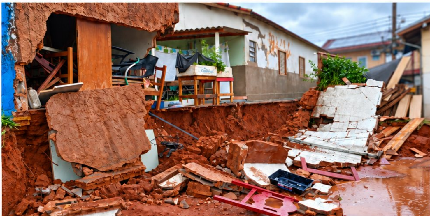
Residência fica parcialmente destruída após o temporal em Avaré, com desabamento de muro e grande volume de lama.
