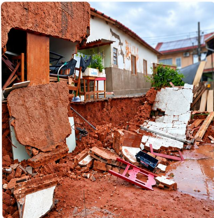
Estragos provocados pela forte chuva em Avaré deixaram imóveis danificados e mobilizaram equipes de limpeza em vários pontos da cidade. Foto: Em Pauta Avaré.
